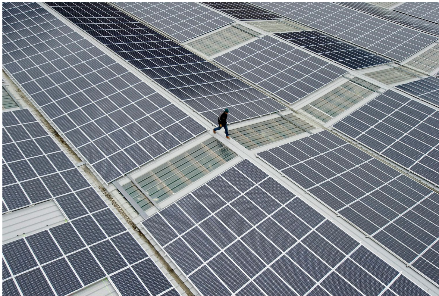
Installation de 7500 mètres carrés de panneaux photovoltaïques sur un toit à Saxon, en Valais. (6 DÉCEMBRE 2011/ JEAN-CHRISTOPHE BOTT/KEYSTONE)
