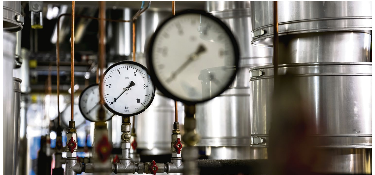
Local technique à l'ONU de Genève-Lac-Nations, qui utilise de l'eau du lac pour rafraîchir les bâtiments du Palais des Nations où GeniLac des SIG viendra compléter ce système de refroidissement. (GENÈVE, 4 AOÛT 2022/MARTIAL TREZZINI/KEYSTONE)
