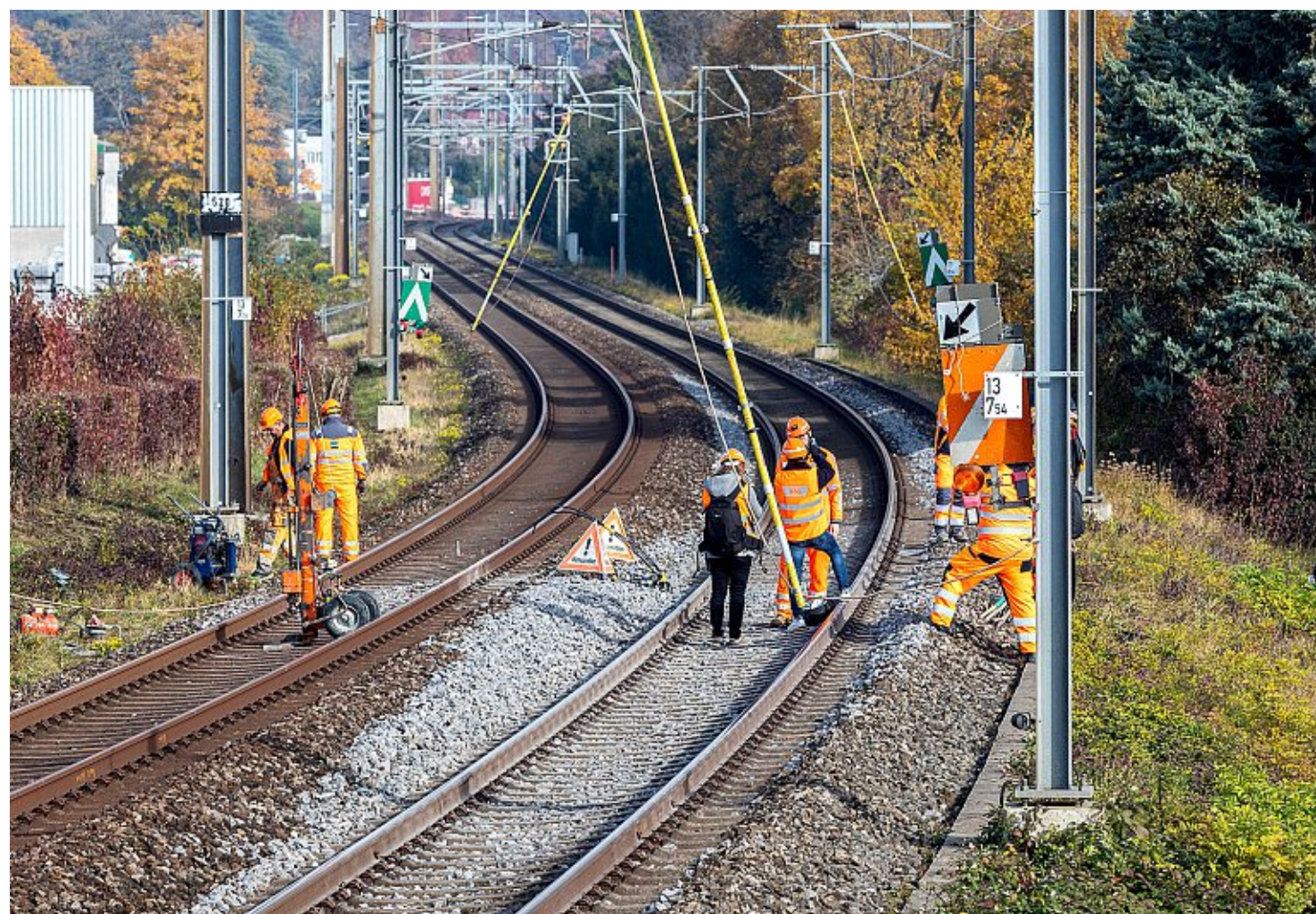
Le trou de Tolochenaz en 2021 a complètement coupé le trafic ferroviaire entre Lausanne et Genève durant plusieurs jours. Rappelant ainsi que l'une des lignes les plus fréquentées du pays n'a pas de tracé alternatif. Vanessa Lam
