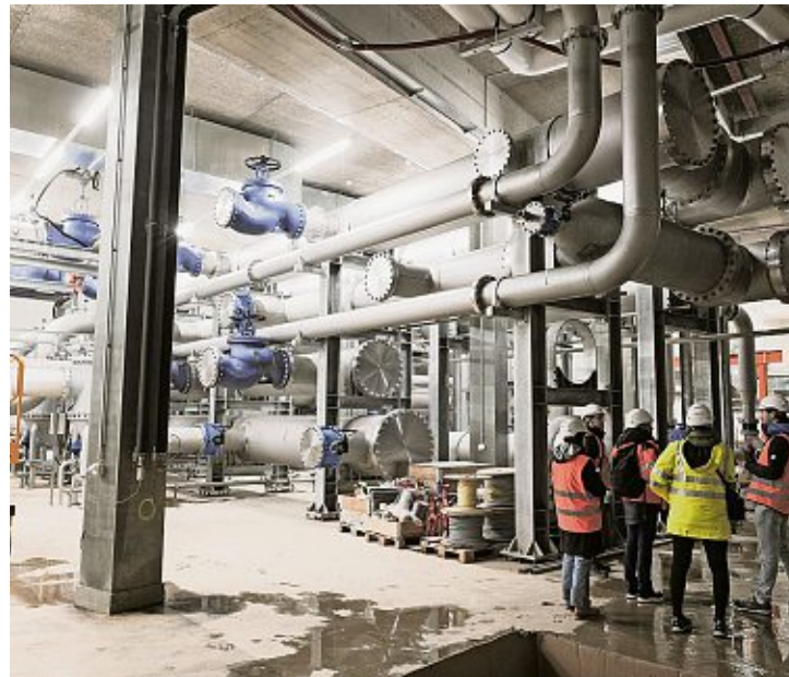
Située dans un sous-sol aux Vernets, la station d'échange thermique devrait être fonctionnelle à la fin de l'année 2026. Laurent Guiraud
