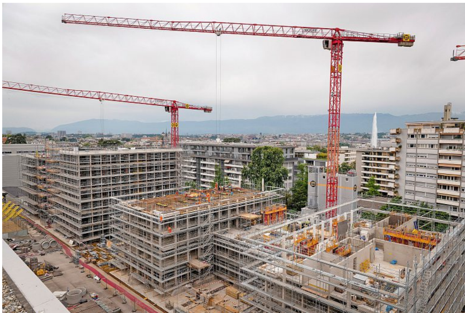
Ce bâtiment hors normes, composé de plusieurs structures, complétera les constructions du plan localisé de quartier. Laurent Guiraud
